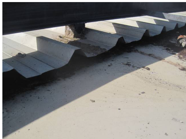
Pesebrón con sección excesivamente horizontal
