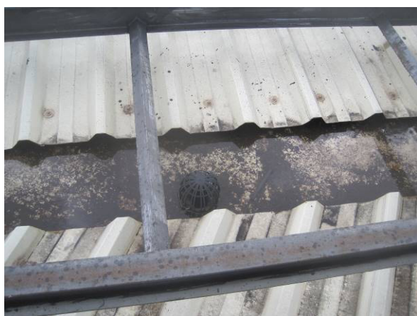
Suciedad en canaleta y estancamiento
