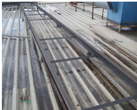
Estancamiento de agua
