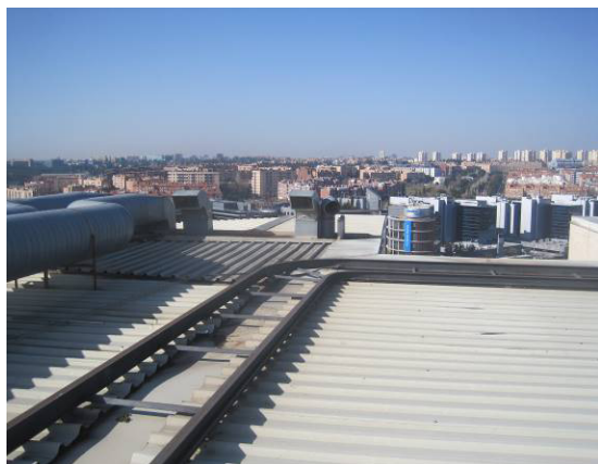
Cubierta chapa gredada, con rail de la máquina de limpieza de fachada
