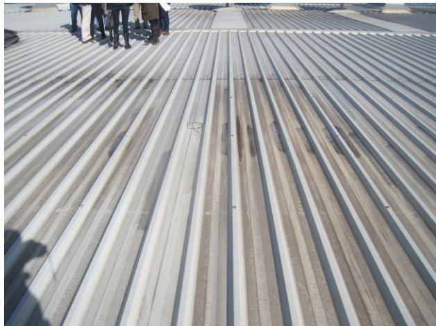
Acumulación de agua
