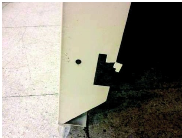
Rotura de pestaña de placa caída
