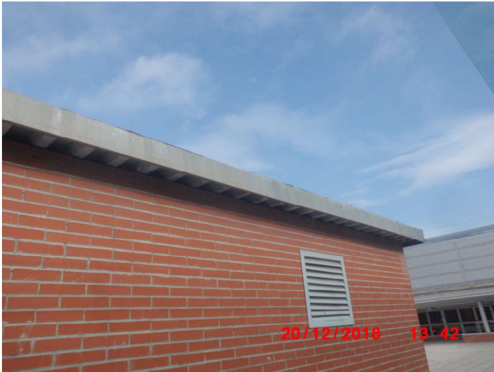
Foto 19: Extremo Este de la fachada Sur del cuarto de instalaciones (UTAs) de la terraza Norte.
