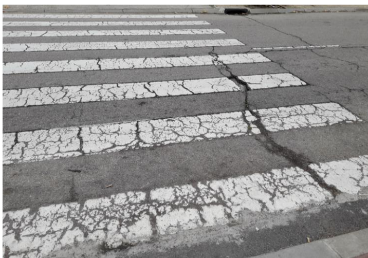
Fotografía nº 4. Paso de peatones en zona oeste.
