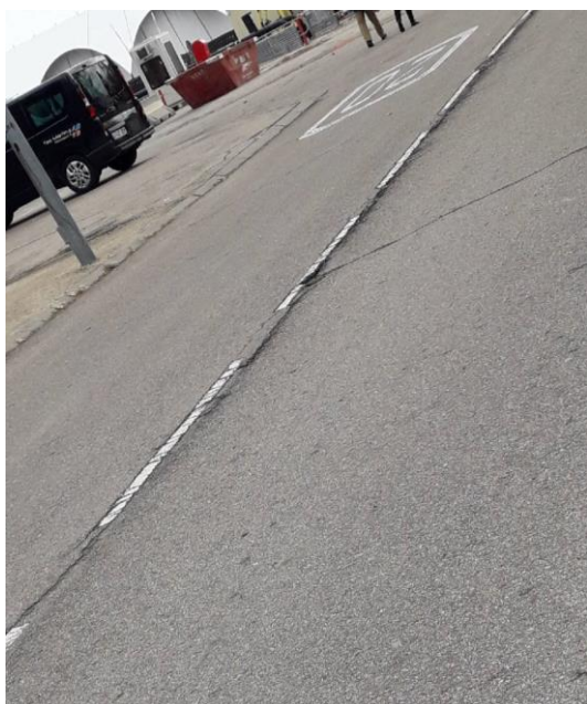
Fotografía nº8. Calzada con numerosos huecos en eje del vial.
