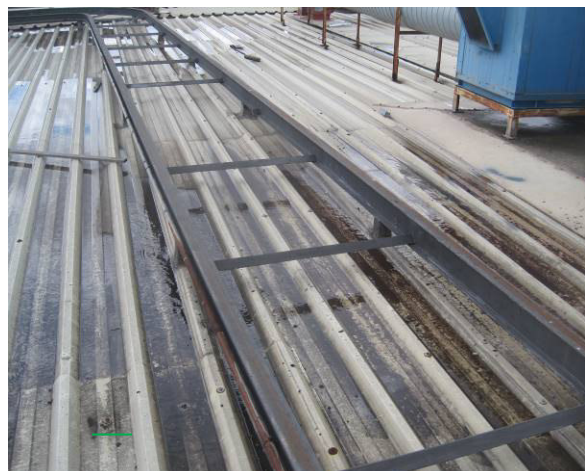
Estancamiento de agua
