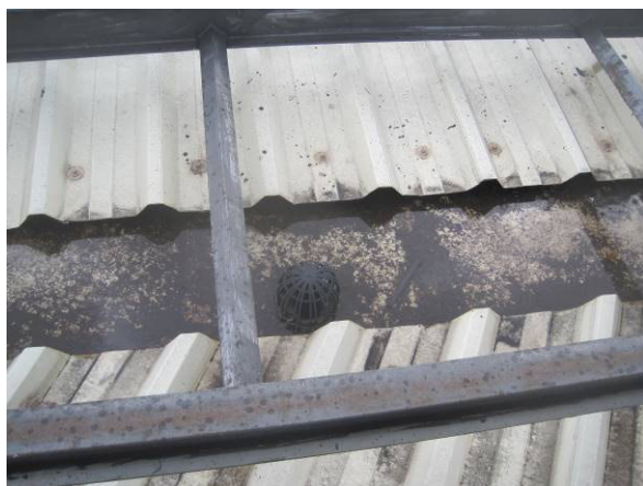
Suciedad en canaleta y estancamiento
