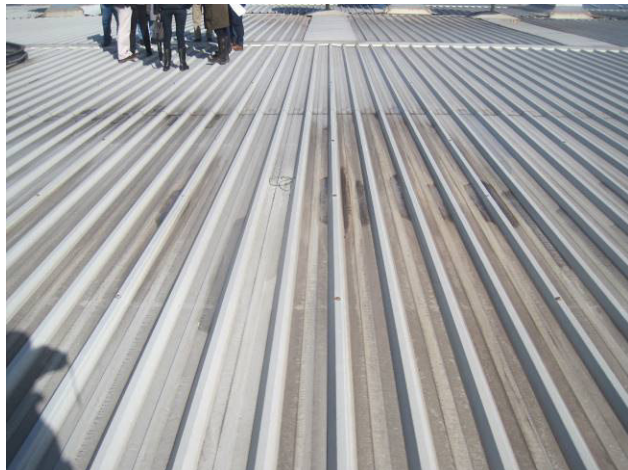
Acumulación de agua
