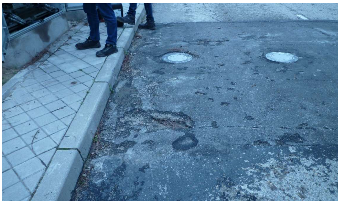
FOTO 13: Cableado al aire del lazo de control de vehículos en la zona de acceso K3 junto al armario A10
