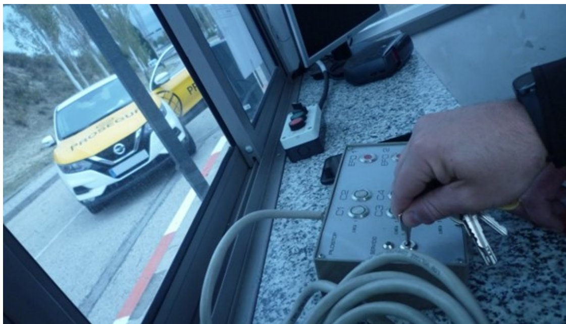
FOTO 14: Prueba de funcionamiento de botonera de garita de control en el acceso K3
