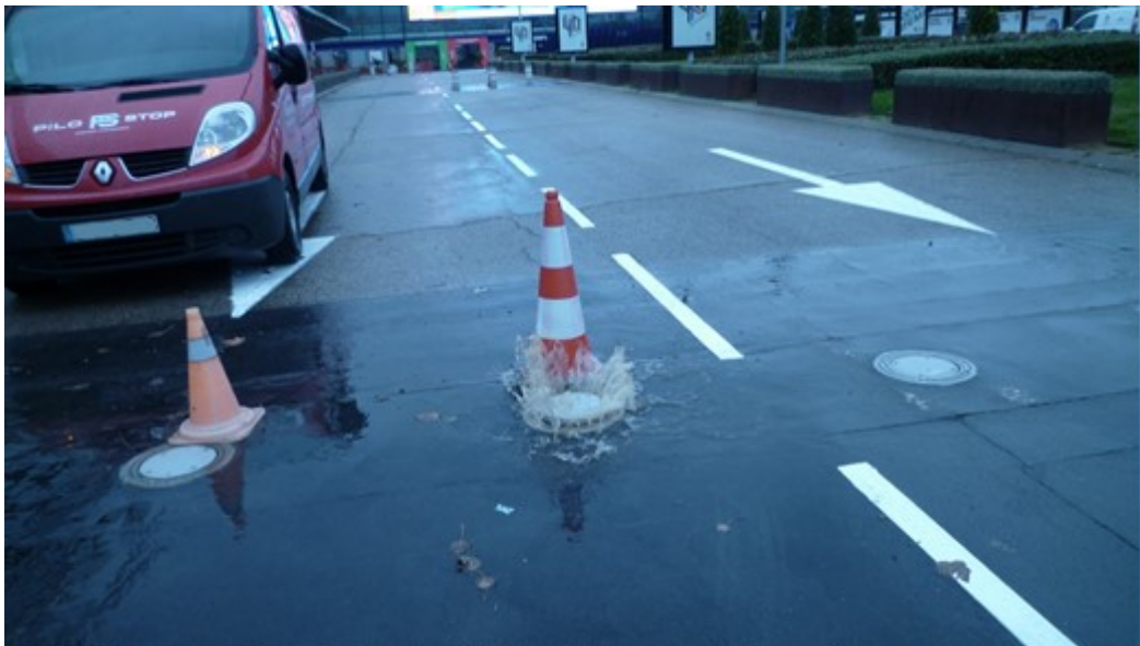
FOTO 4: Salida de agua durante la bajada de la pizona, acceso k1
