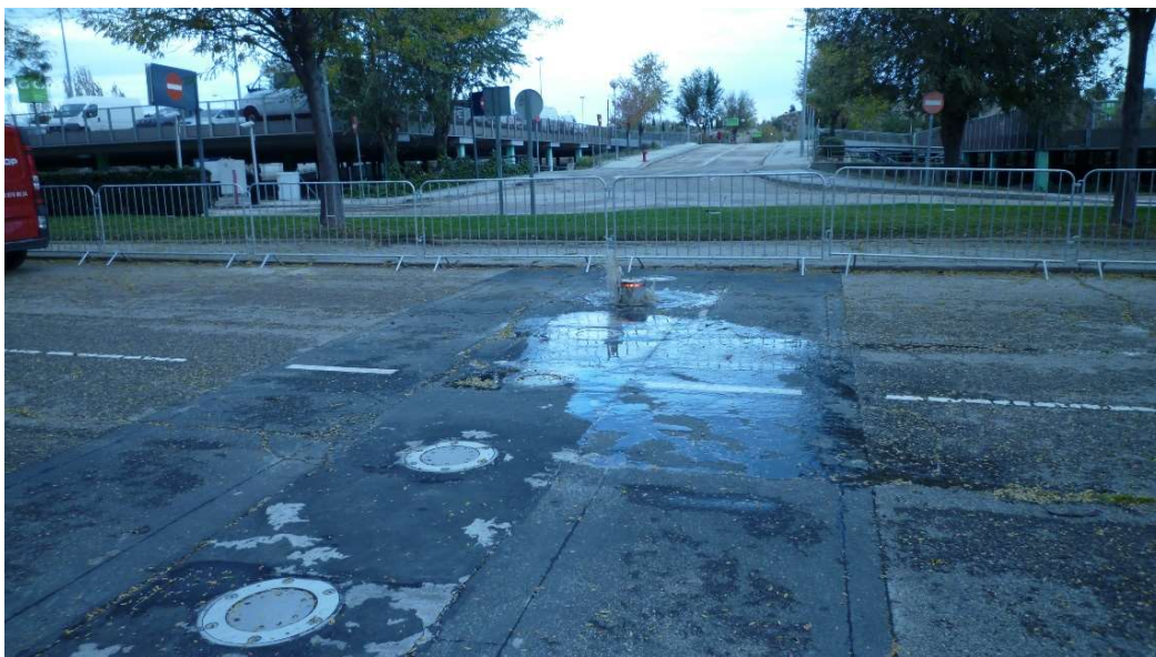
FOTO 10: Salida de agua en la bajada de una de las pilonas del acceso K2.
