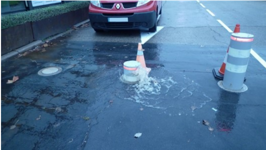
FOTO 5: Salida de agua durante la bajada de la pilona, acceso k1
