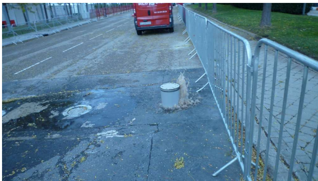
FOTO 11: Salida de agua en la bajada de una de las pilonas del acceso K2.
