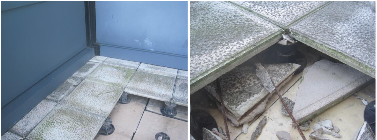
Estado actual del pavimento existente
