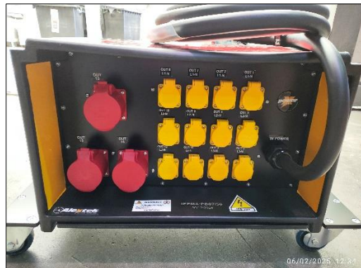
Panel frontal con las CETAC de conexión
