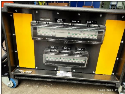
Panel trasero con protecciones y ventanas de acceso a ellas
