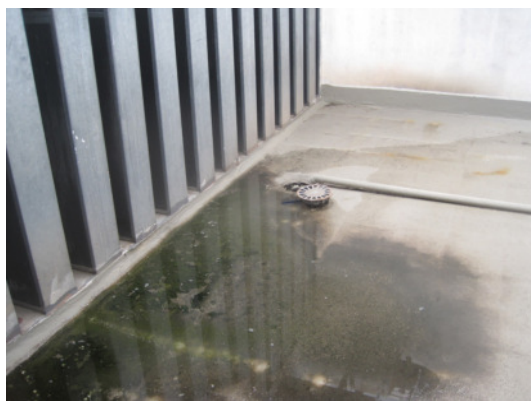
Acumulación de agua
