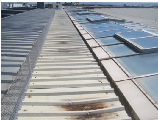
Hundimiento de chapa, lateral de lucernario
