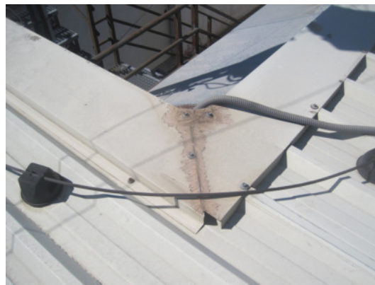
Ejecución indebida de chapas
