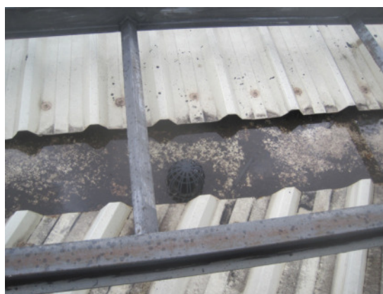
Obstrucción de cazoleta
