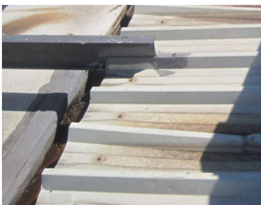
Suciedad en canaleta y estancamiento de agua
