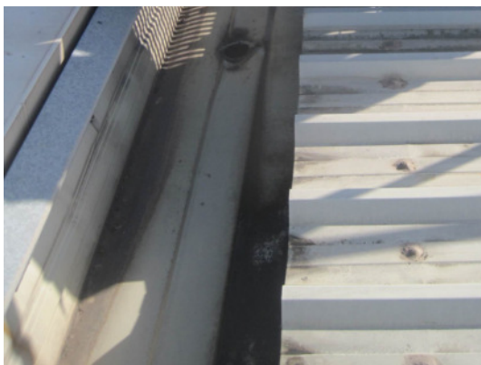
Suciedad en extremos de cubierta
